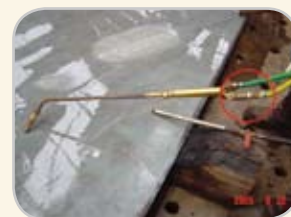
취관에 안전기 설치
